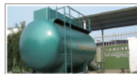
永记造漆(昆山)有限公司 废水处理及回用工程 (60m 3 /d)
