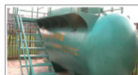
南昌扬子洲新村 生活污水处理及回用工程 (25m 3 /d)
